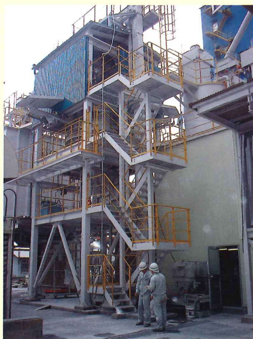
建設工業のための生石灰の高温クリンカリング 12ton/day、2002年建設 High-temperature clinkering of quick lime for the construction industry, 12 tons of product per day, constructed in 2002
