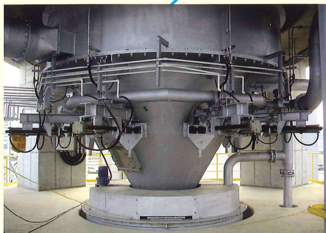
排鉱調整プッシャー及び回転スクレーパー DISCHARGE (ADJUSTMENT) PUSHER AND ROTARY SCRAPER
